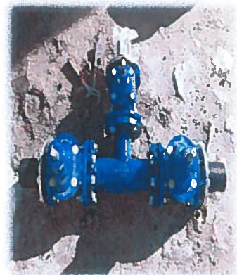
Nó de ligação da rede de água
