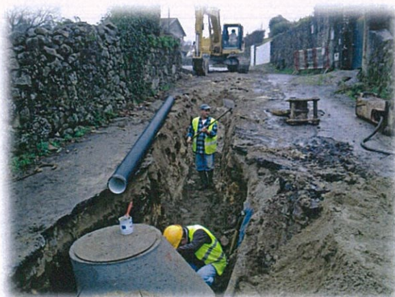
Figura 5 – Instalação de coletor de águas residuais e remate de caixa de visita
