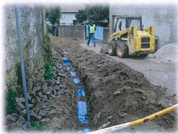
Figura 2 - Instalação de abastecimento
