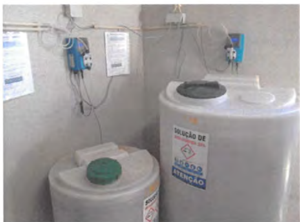
Melhoria dos sistemas de tratamento de água
